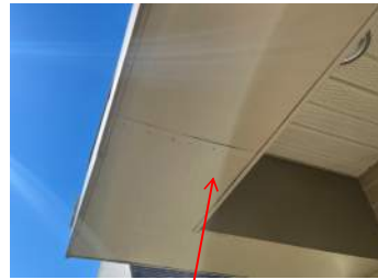
Loose soffit metal
