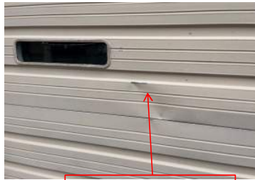
Damaged O.H. Door
