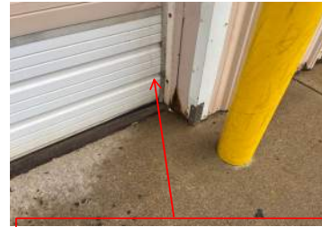
Different Color O.H. Door Section and Rusting O.H. Door Frame/Jamb
