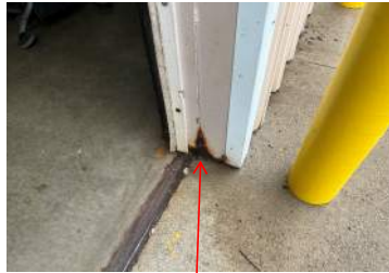
Rusting O.H. Door Frame/Jamb
