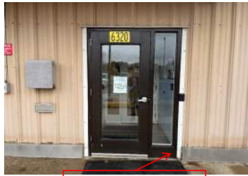
Rusting Door Frame
