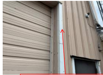
Damaged O.H. Door Frame/Jamb
