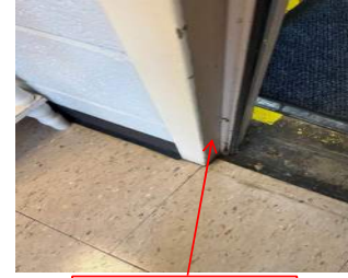
Rusting Door Frame
